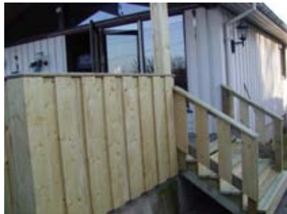
Ikke samkjørt rekkverk på veranda og trapp
