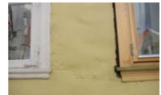
Det gamle vinduet til venstre har kittfals mot glasset og synlige vinkelbeslag. Det nye vinduet har glasslist på siden og en svært synlig aluminiumslist i bunn. Høvlet og profilert belistning er like, men ikke identiske.
