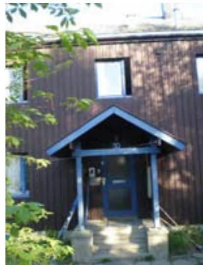
Rehabiliter og etterisolert. Nyutvikling som blir for flat og uten relieff med nytt vindusformat uten belistning og forenklet panel. Inngangen er fint og tydelig markert.
