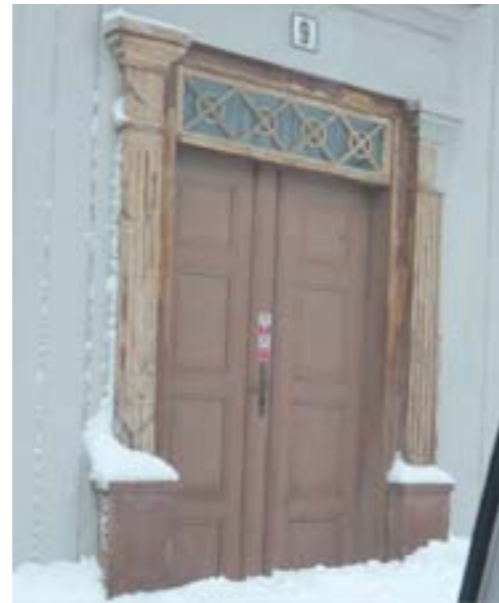
Solbugården: Staselig, verdig, rikt detaljert bevaringsverdig inngangsdør
