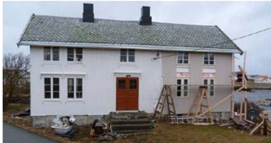
Restaurering på Titran: Originale vinduer til venstre og de nye vinduene til høyre er ikke identiske- legg merke til glassformatene,
